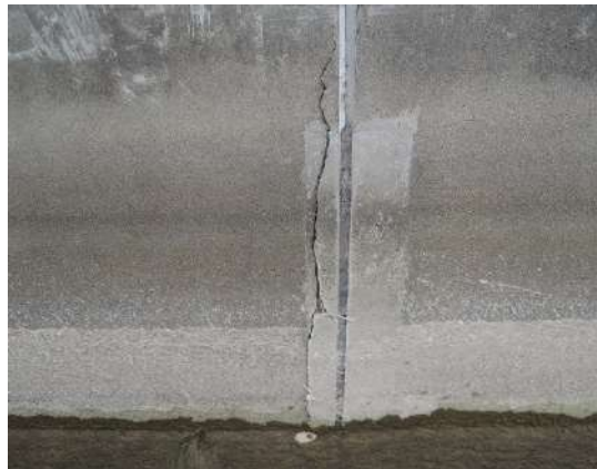
写真 5.1.4.3-1 目地に起因したひび割れの事例
