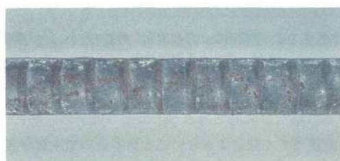
腐食度区分：A 又は I
