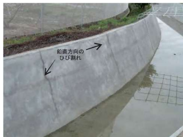
写真 5.1.4.2-2 ポリマーセメントモルタル（PCM）のひび割れ 4)
